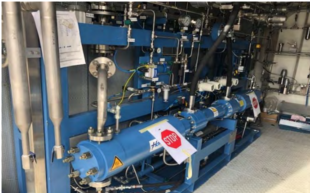
Abbildung 53: Kolbenkompressor mit einer Leistung von ca. 20 kg/h
